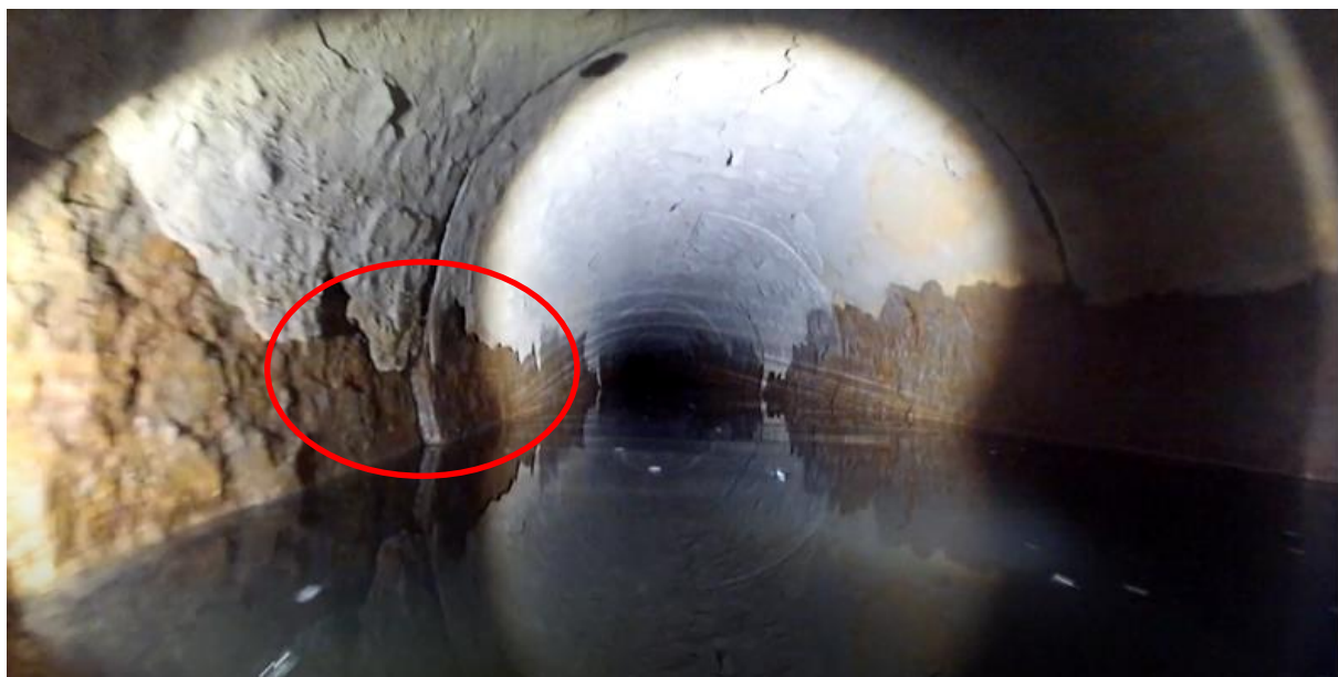
Figura 9 – Folgas entre as ligações dos tubos.
