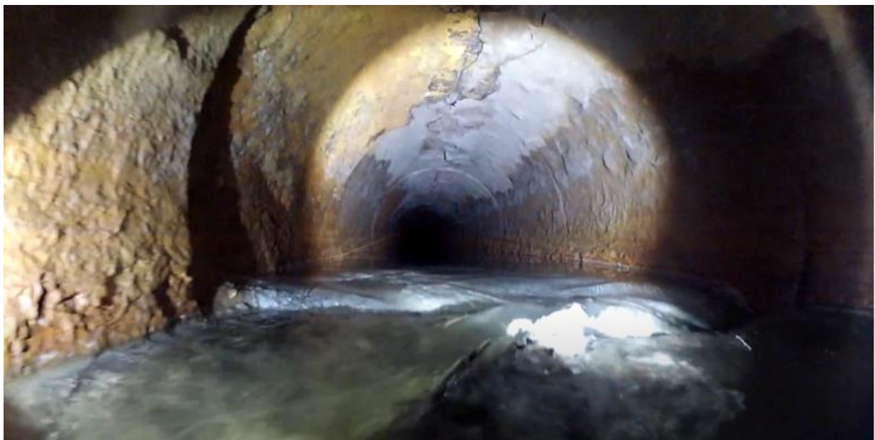
Figura 11 – Obstrução parcial da galeria a aproximadamente 16 metros de distância da boca de jusante da galeria.
