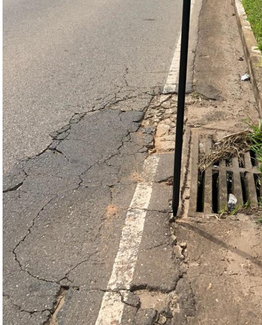
Figura 3 - Erosão no bordo da pista de rolamento.
