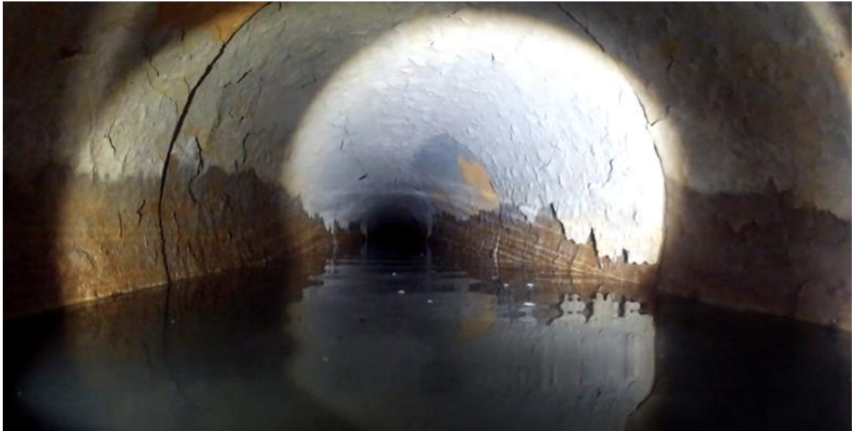
Figura 8 – Desgaste da parede interna da galeria.
