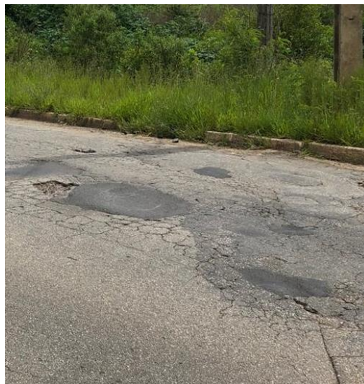
Figura 4 - Desprendimento da pavimentação asfáltica da via.
