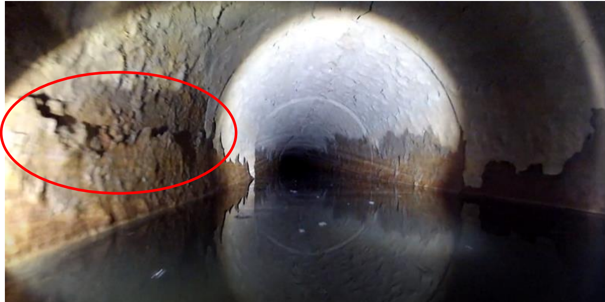
Figura 10 – Fissura lateral do tubo.
