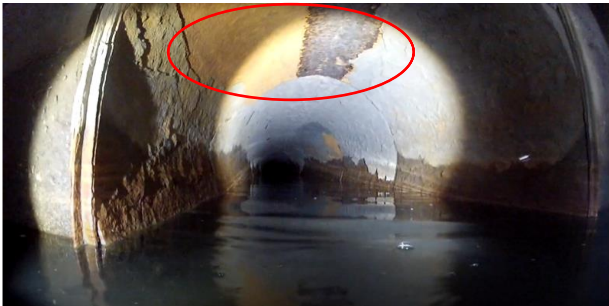
Figura 7 – Oxidação e descolamento de placas do topo e das laterais da tubulação.
