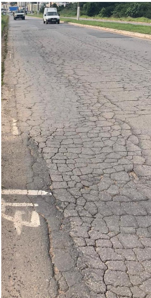
Figura 2 - Trincas tipo "couro de jacaré" oriundas da fadiga de pavimento
