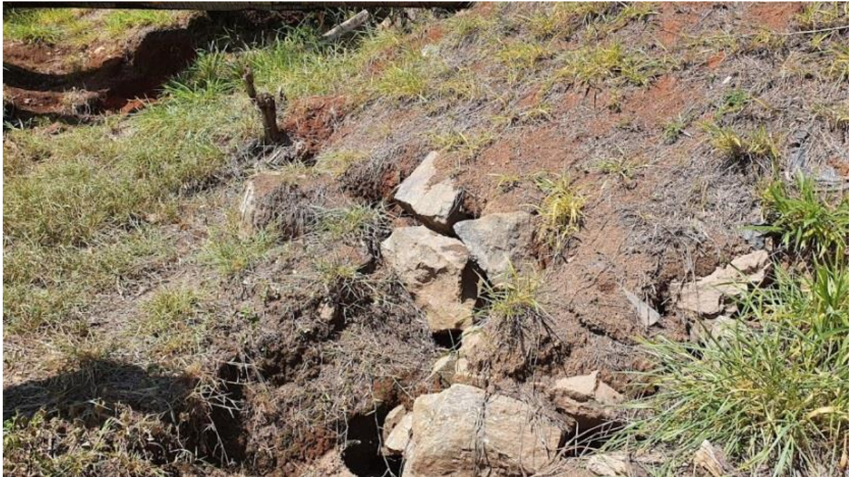
Figura 12 – Erosão no maciço do talude de montante do Dique 1. Trecho onde houve perda de material interno do maciço por carreamento hidráulico.
