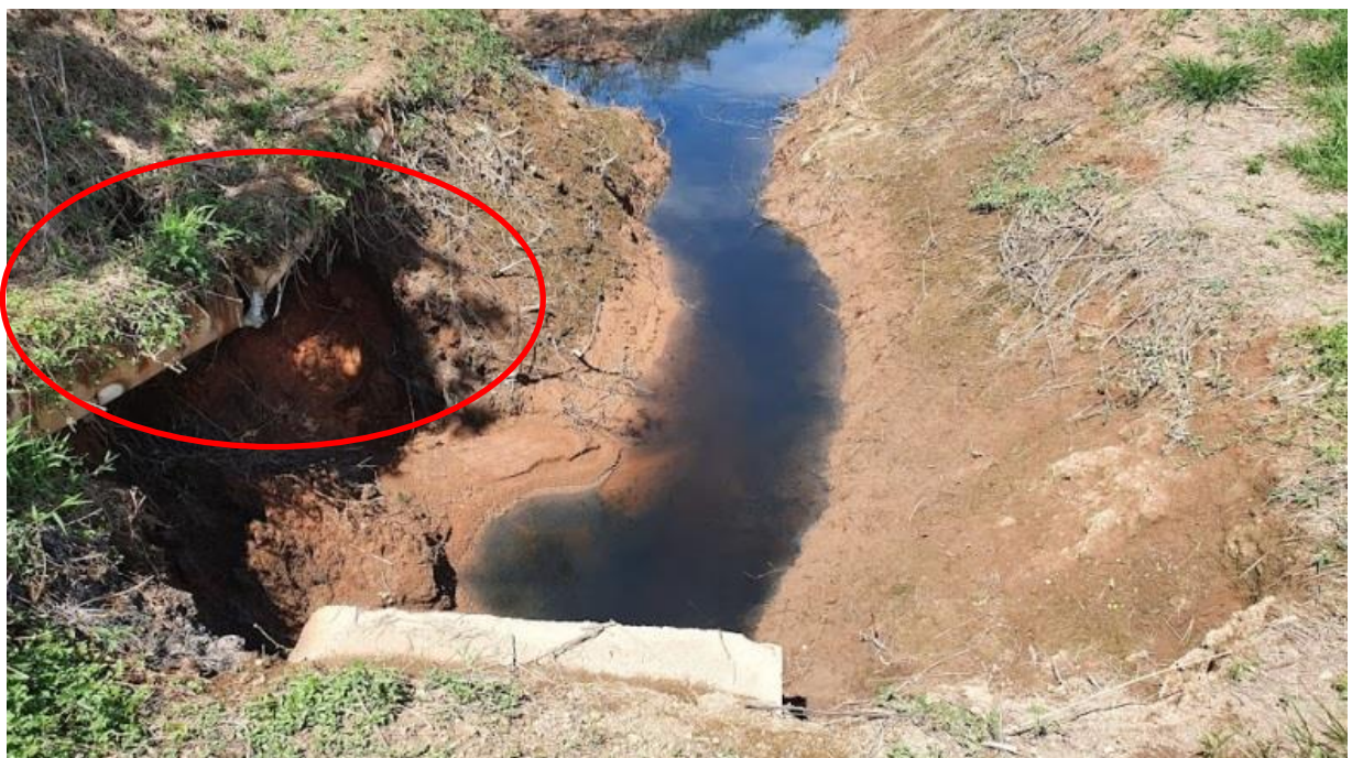
Figura 13 – Rompimento das tubulações de recalque das bombas gerando erosão marginal do canal de drenagem que esgota a galeria.
